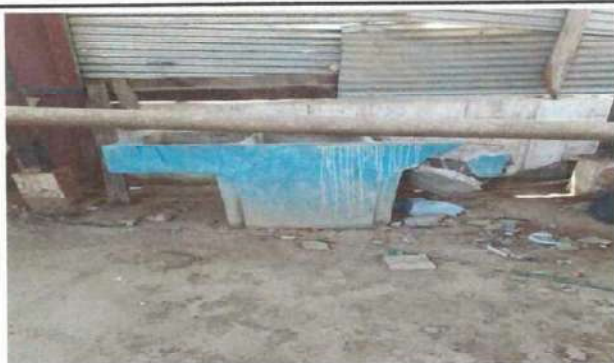
Foto 3: Se observa el lugar deteriorado para el mejoramiento del deposito de agua para lava manos de los niños y niñas del modulo 1.
