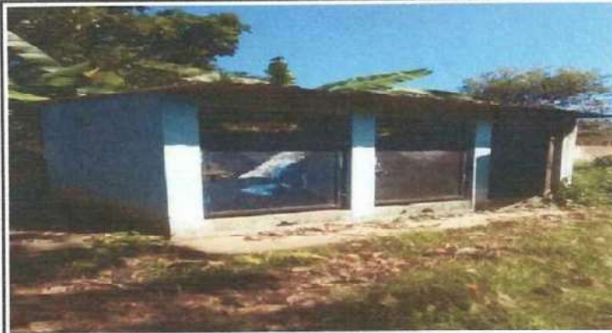
Foto 2: Se observa los baños de las niñas en mal estado del establecimiento del modulo 1.
