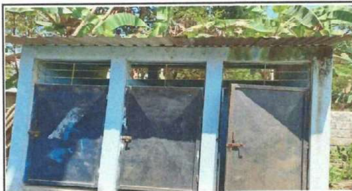
Foto 4: Se observa el lugar dañados para la rehabilitación de tres baños y mingitorio para niños del modulo 1.
