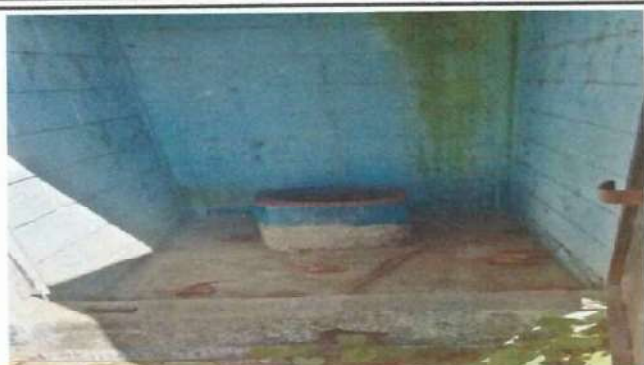
Foto 1: Se observa el deterioro de los baños de mingitorio para niños en mal estado del establecimiento del modulo 1.
